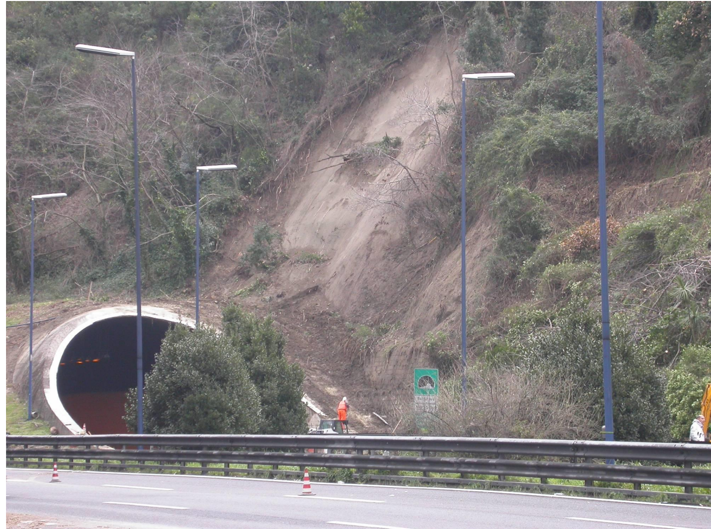
Frana lungo la tangenziale di Napoli (2005).
